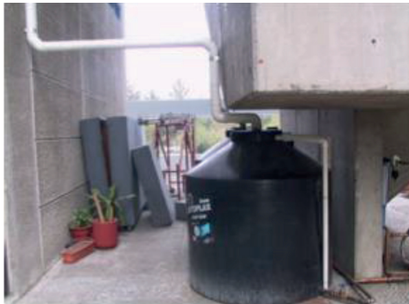
FIGURA 12. Cisternas Prefabricadas de polietileno de la marca ROTOPLAS. Fuente: Adler et al. , 2008.
