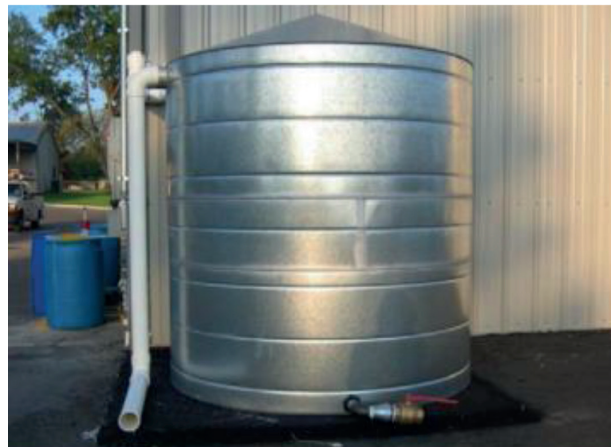
FIGURA 17. Cisterna de acero galvanizado. Fuente: The Texas Manual on Rainwater Harvesting.
