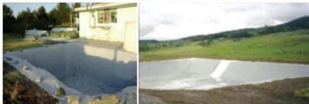
FIGURA 15. Cisternas con Geomembranas. Fuente: Peraza-Gómez, 2011.
