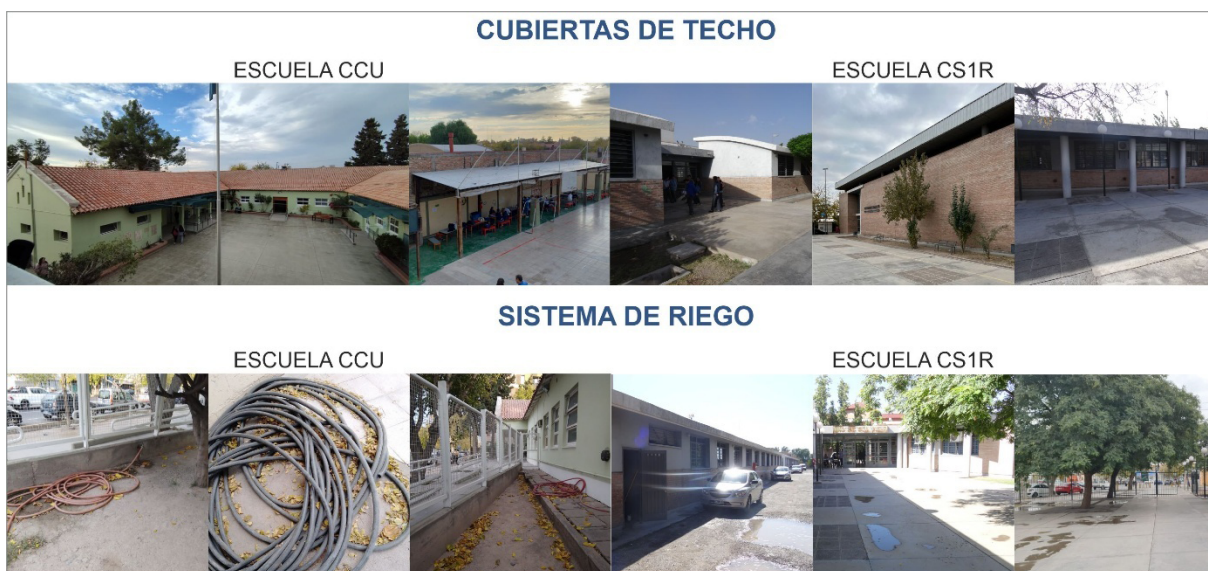
Figura 7 Cubiertas de techo en CCU y CS1R (sup.) y Sistema de riego en CCU y CS1R (inf.).
