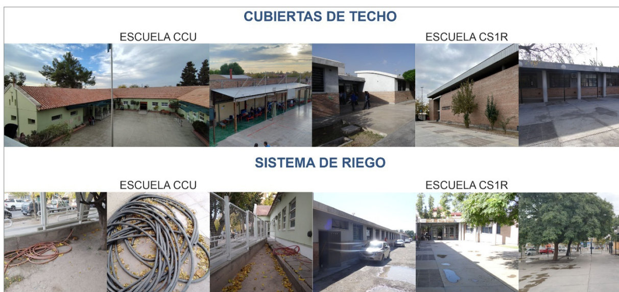
Figura 7 Cubiertas de techo en CCU y CSiR (sup.) y Sistema de riego en CCU y CSiR (inf.).
