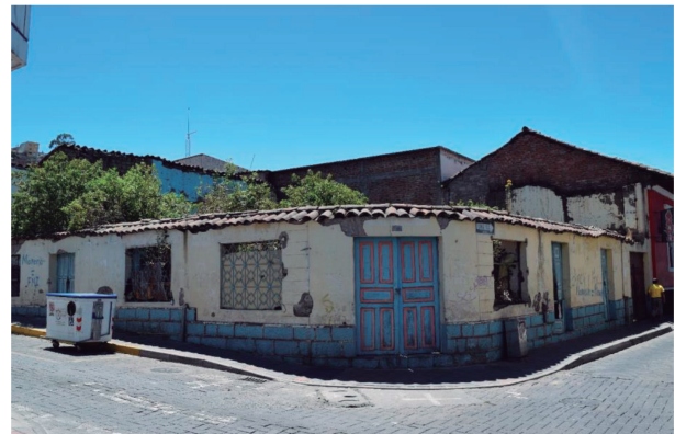
Casa patrimonial destruida
